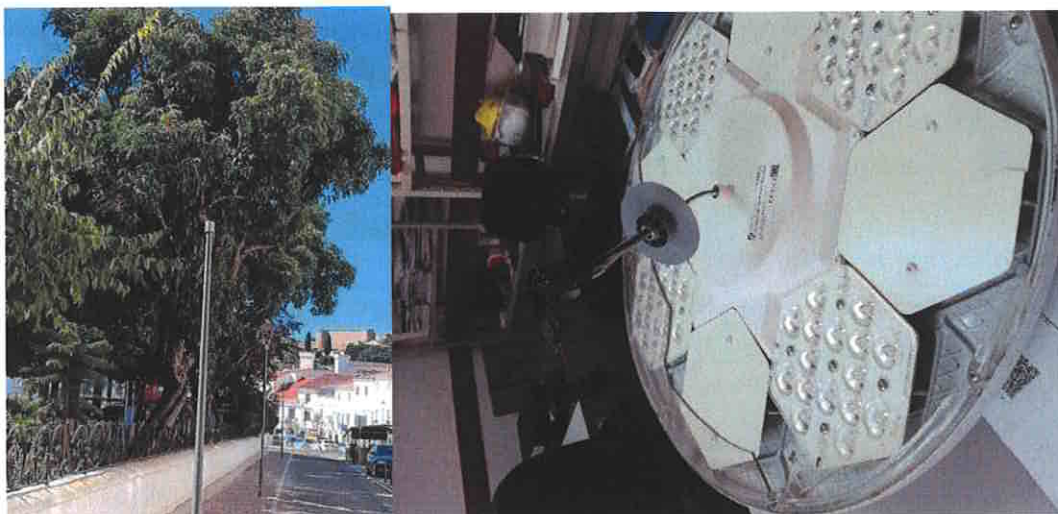
Figura 96 Exemplo de iluminação pública danificada no município de Estremoz
