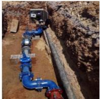
Imagem 2. Instalação de telemetria no contador da ZMC
