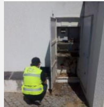
Imagem 4. Ponto de Monitorização de Pressões na Subzona 2
