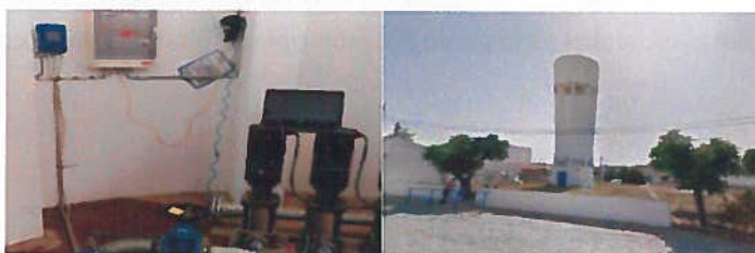
Figura 6 - Instalação da sonda de impulsos e equipamento de telemetria no medidor de caudal do reservatório de Aguilar para recolha de dados de caudal e pressão a cada 15 minutos (Aguilar, Viana do Alentejo, 22/06/2016).
