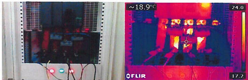
Figura 13 - Termografia dos Quadros elétricos.
